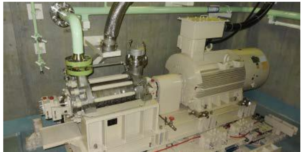
蒸気発生器代替注水ポンプ
