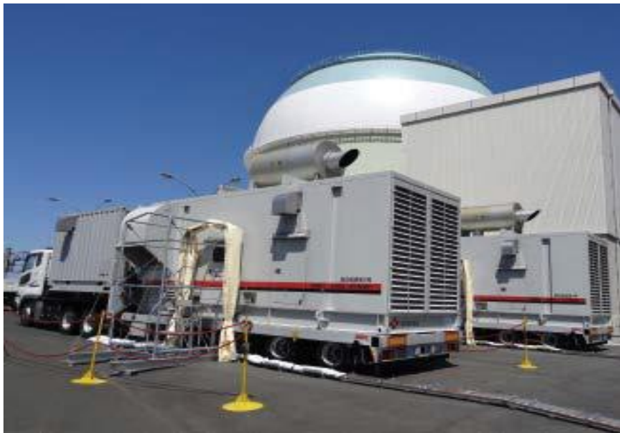
空冷式非常用発電装置
