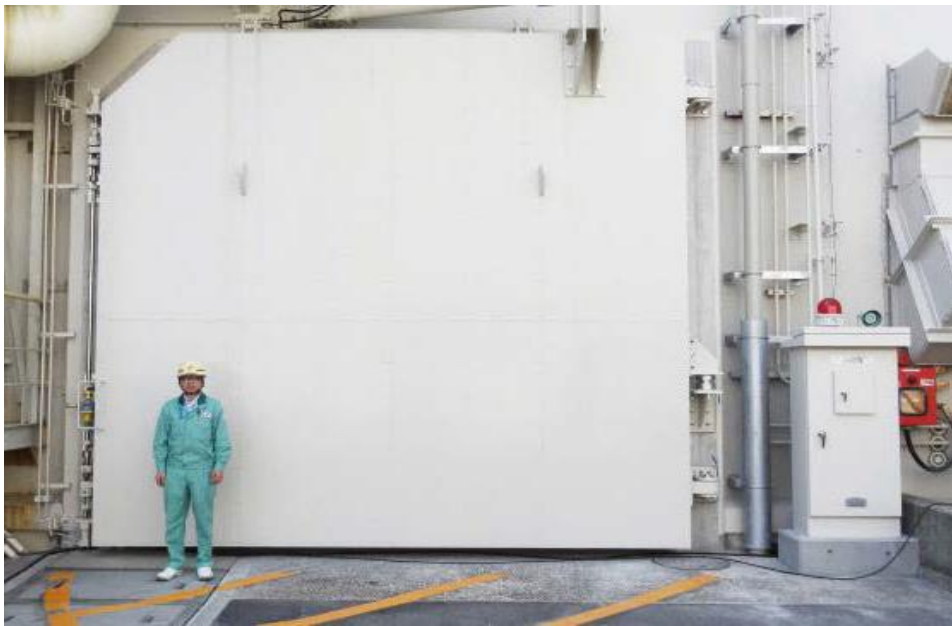
大型水密扉(扉の厚さ35cm)
