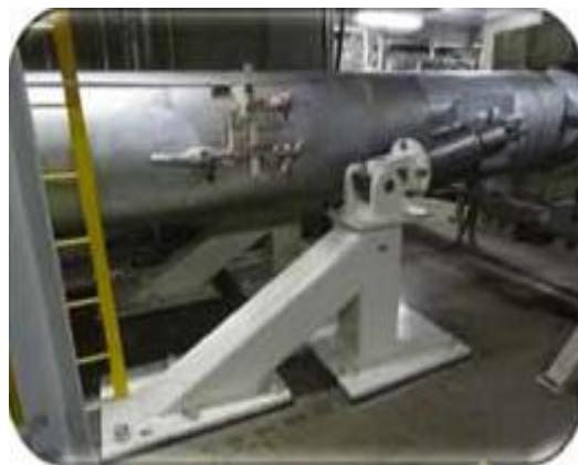
主蒸気設備配管
