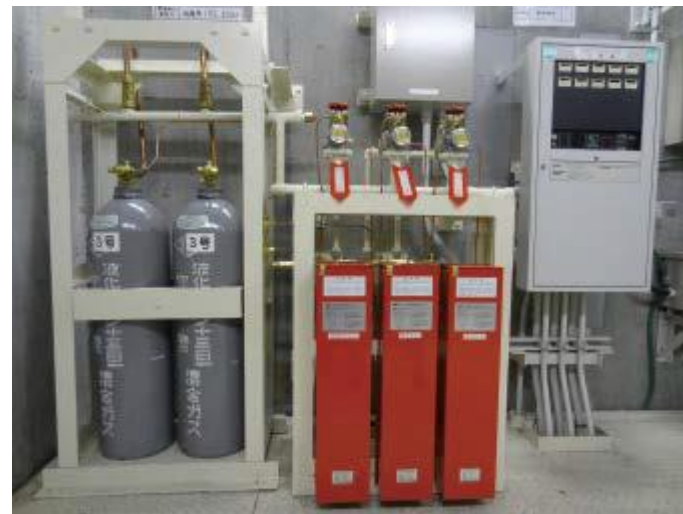
自動消火装置 (ハロン消火装置)
